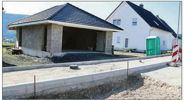
Deutliche Höhenunterschiede zwischen den Einfahrten und der neu gebauten Straße machen einigen Anliegern aus dem Fahler zu schaffen. Manche haben derzeit keine Chance, aus ihrer Garage auf die Straße zu fahren, weil ein extremer Höhenunterschied zu überwinden ist. (Foto: Triesch)
