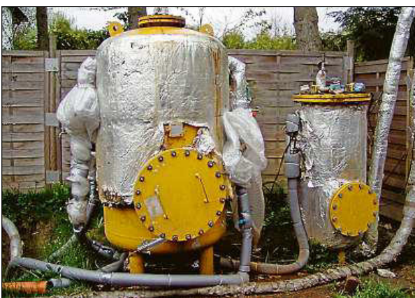
Nicht gerade vertrauenswürdig sieht die Filterstation aus, die das versickernde Oberflächenwasser und die Raumluft aus einem der Häuser von krebserregenden Kohlenwasserstoffen säubern soll. Funktioniert die Anlage überhaupt noch, fragen sich die Weidelbacher. Oder fließt das Wasser einfach ungeeignet in den Bach?
